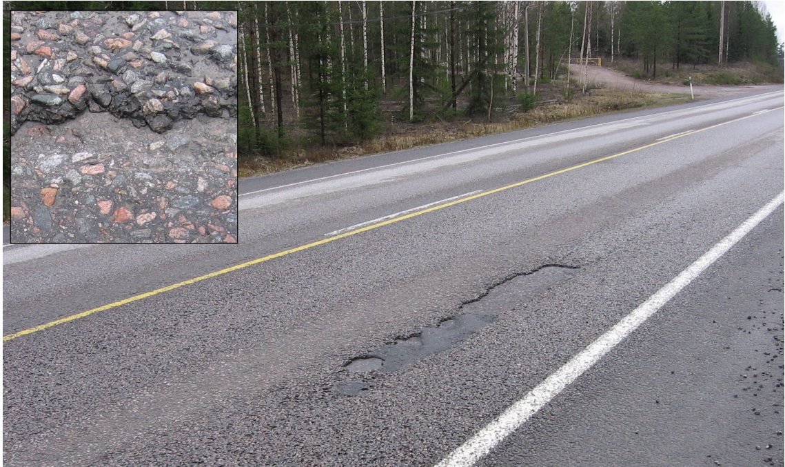
Kuva 15. Varsin ohut SMA16/70 –päällyste vuodelta 2003 on purkautunut valtatiellä 25 Hyvinkäällä. Kuva otettu toukokuussa 2007. Suurennoksessa näkyy, että päällyste on paikoin vain yhden kivirakeen paksuinen.
